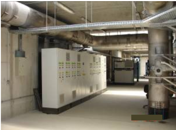
Upravljački sustavi puhala i drugih motornih pogona
